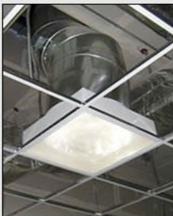
21" 530 mm met transito box in systeemplafond
